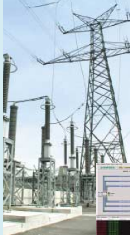
Pylône et poste 176, fin de la ligne aérienne et début de la liaison GIL
