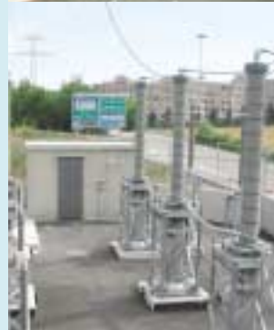
Poste 175, transition aérienne-souterraine
